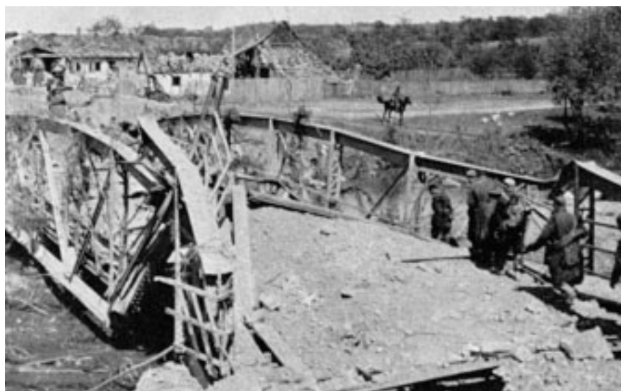
■ Un ponte sulla strada per Zagabria distrutto dai tedeschi per fermare l'avanzata partigiana.
